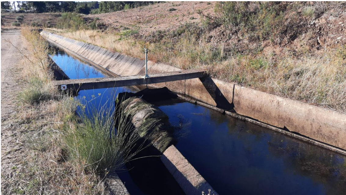
Figura 11- Canal de rega com necessidade de limpeza
