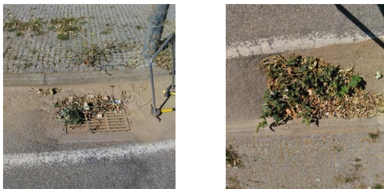
Figura 6- Exemplos de obstrução de sarjetas
