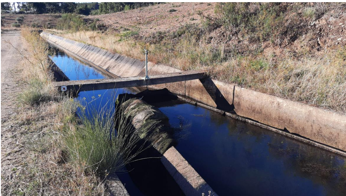
Figura 11- Canal de rega com necessidade de limpeza
