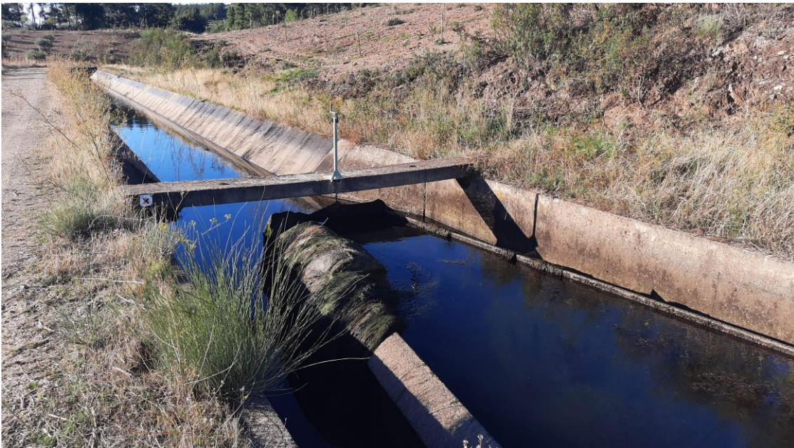
Figura 11- Canal de rega com necessidade de limpeza
