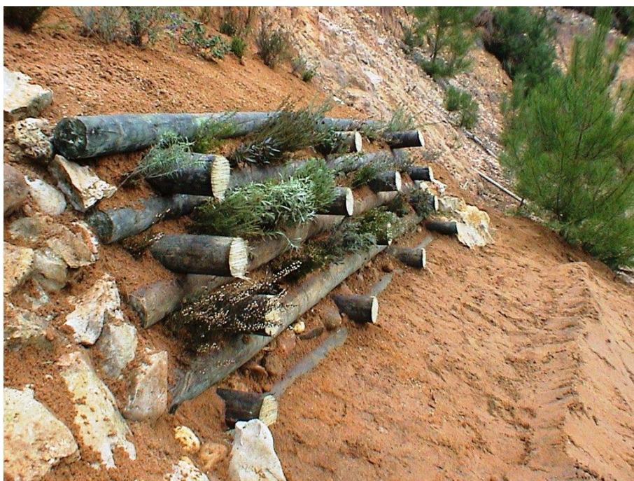
Figura 51- Muro de suporte vivo, em madeira (tipo “cribwall”) (Fonte: Engenharia Verde )
